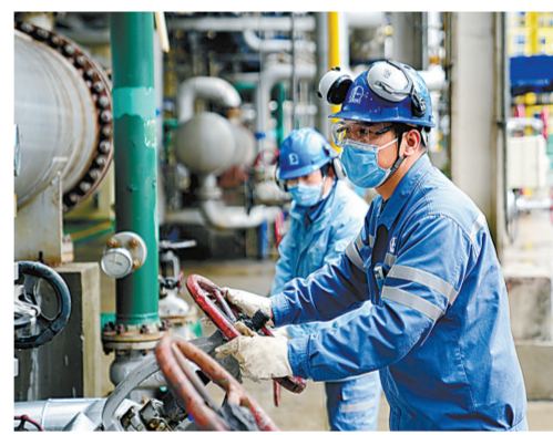
3月25日,上海石化炼油部5号炼油联合装置员工在现场作业。
