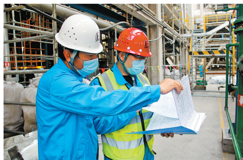
十建公司安全员在福建联合石化EO/EG装置检修改造施工现场协助分包商分析安全风险隐患。
