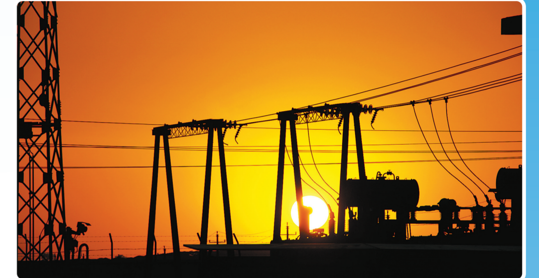
东胜气田供电电网。 姚冬摄
