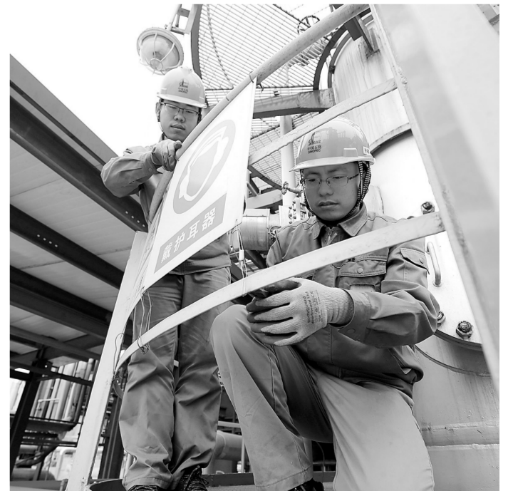
近日,齐鲁石化扎实开展百日安全无事故专项行动,针对春季风大、风多的特点,组织防高空坠物专项检查,从细节入手自查自改,消除安全隐患。图为齐鲁石化员工对装置区锈蚀的标识牌进行固定。王敬华 摄
